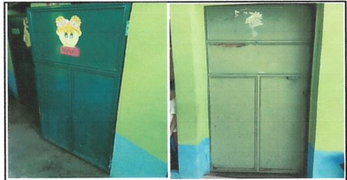
Foto 6: Las puertas tanto en aulas y areas de sanitario se encuentran dañadas por factores a causa de humedad y deterioro por corrosión en la estructura.
