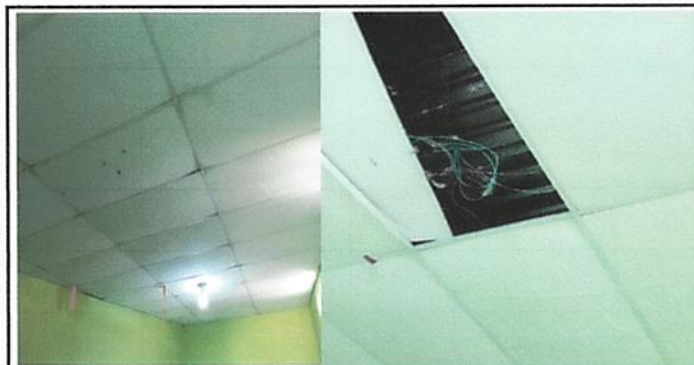
Foto 5: El area de lamparas y cableado en interiores de las aulas se encuentran en malas condiciones y la falta de iluminación en los ambientes de las aulas.
