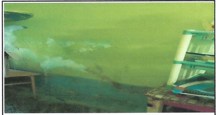
Foto 4: Las paredes se encuentran deterioradas debido a la humedad por las lluvias.
