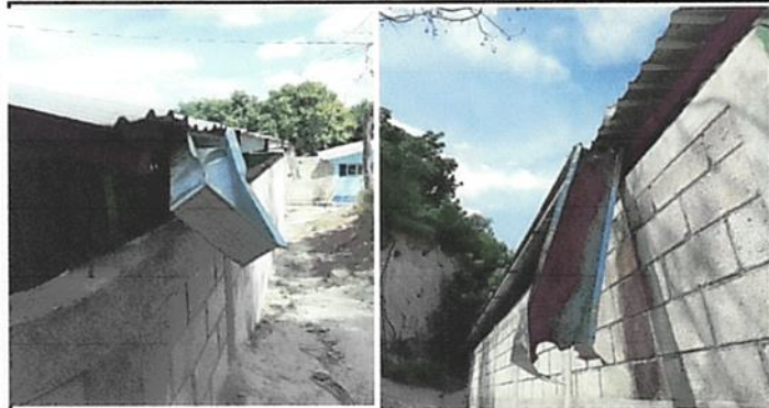
Foto 1: Los canales se encuentran dañados y en el tiempo de invierno daña las paredes debido a la humedad por la lluvia.
