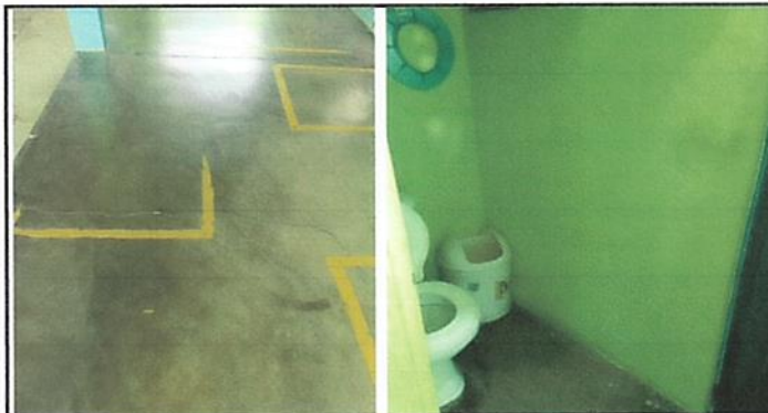
Foto 3: El piso se encuentra en malas condiciones debido a grietas y levantado del mismo tanto en exteriores e interiores y la falta de protección en las paredes de los sanitarios por factores de humedad.
